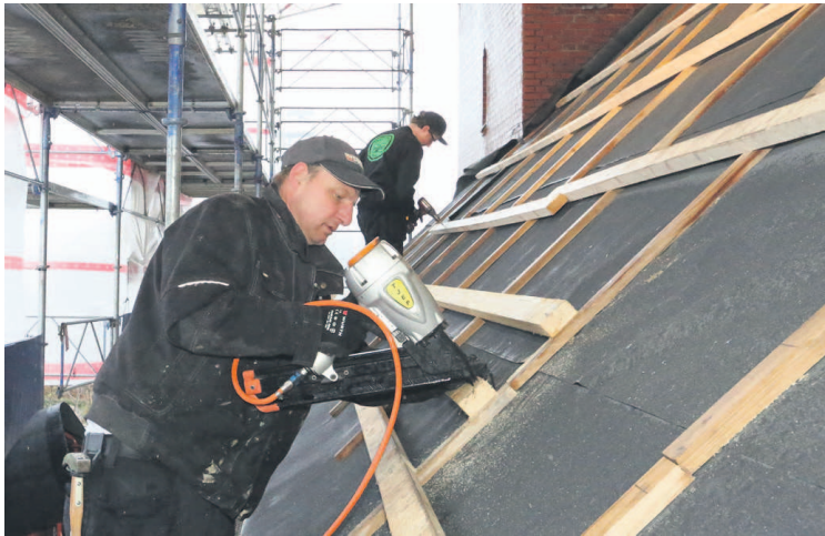
Tommerne Flemming og Kristian fra Skovlundgaard Byg, i fuld sving med at montere nyt undertag og lægter. FOTO K.E. HANSEN
